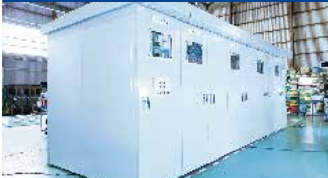
屋内外キュービクル式受変電設備
