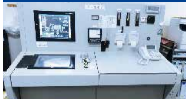
中央監視システム
